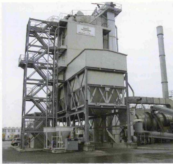
L'impianto di produzione asfalto realizzato dalla Asphalt Technologies per l'Impresa Bacchi
